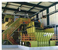
H 社 (混廃破砕処理)
